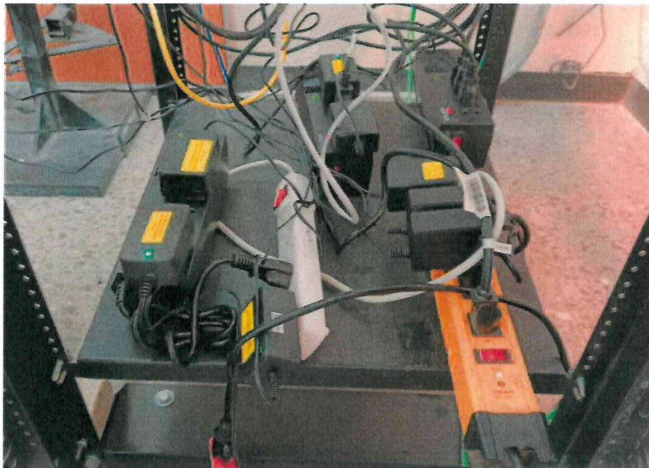
2 no breaks reubicados para protección de servidores y telefonía
