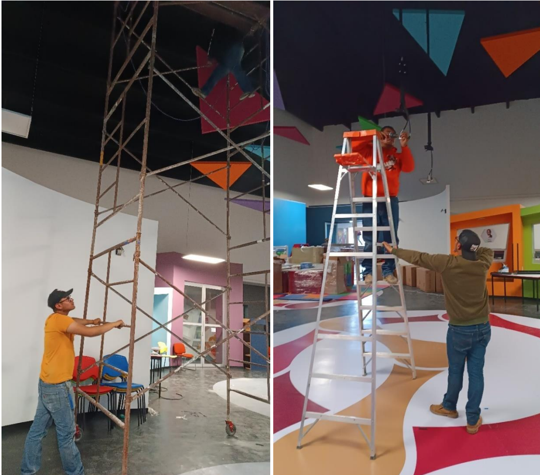
Trabajo en las alturas para instalación eléctrica, soportes de proyector, cableado de video y adornos
