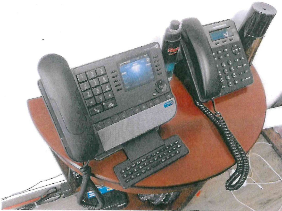
Instalación de teléfono rojo en oficina del Despacho de la Secretaria.
